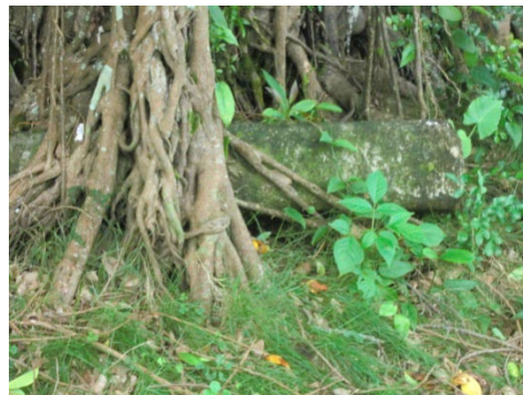
写真6. ガジュマルが柱を抱えている様子
